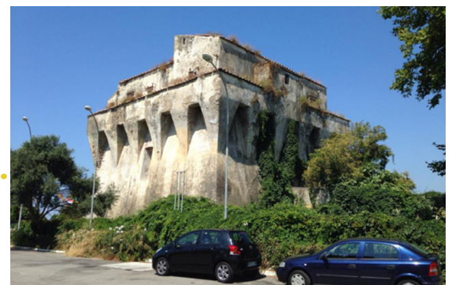
Torre Angellara in stato di abbandono
