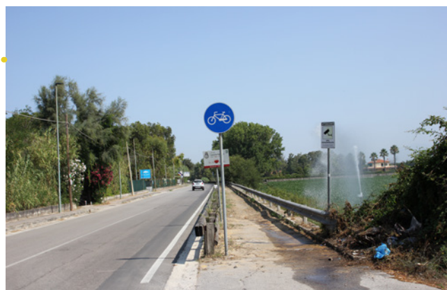
Pista ciclabile in stato di abbandono
